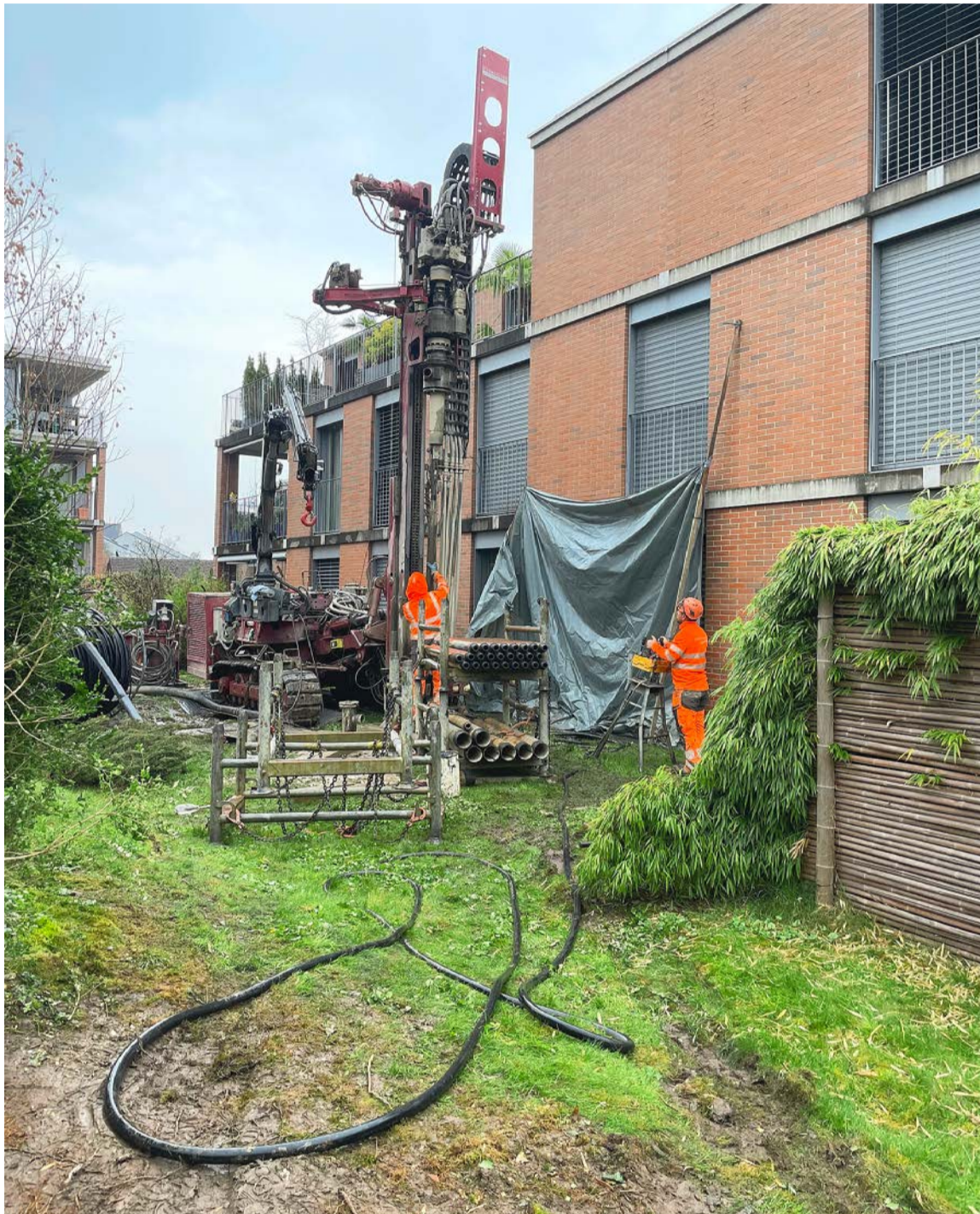
Oben: Erdsondenbohrungen für das Haus 3. Die Fassade wird mit einer Plastikabdeckung vor Schmutz geschützt. BILD DANIEL HÄNI
